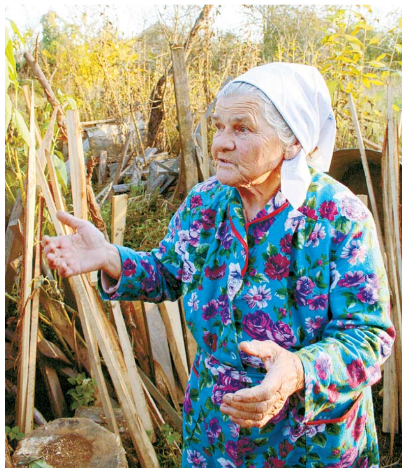
В хате Марии Дмитриевны кое-где обваливается потолок, в стенах образовались трещины, но ветхое строение ремонтировать некому.
